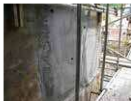
アバット補修の事例
