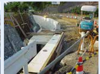
ガードレール
